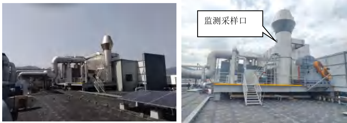
图 4.1-8 水性漆喷漆线废气治理设施
