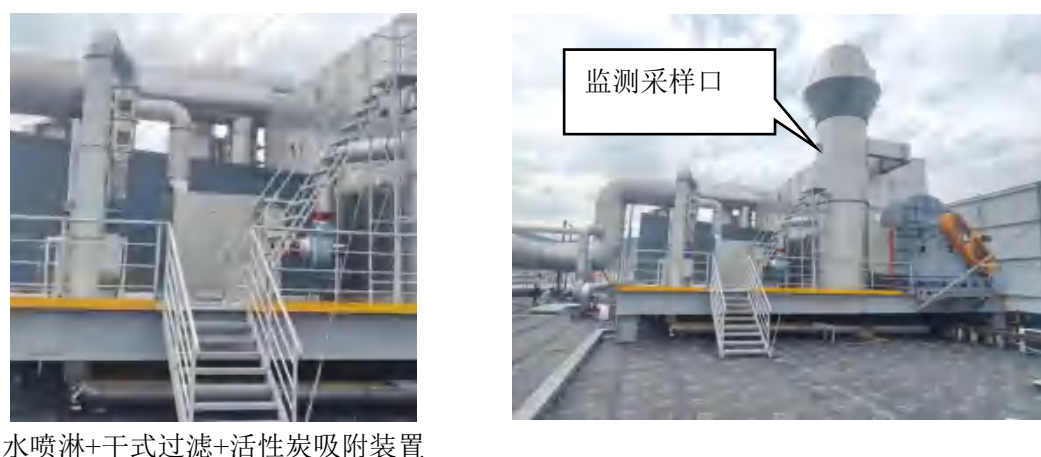
图 4.1-5 塑粉固化废气治理设施
