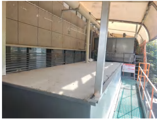
图 4.1-10 污水处理站废气治理设施
