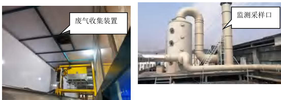
图 4.1-7 中和废气治理设施
