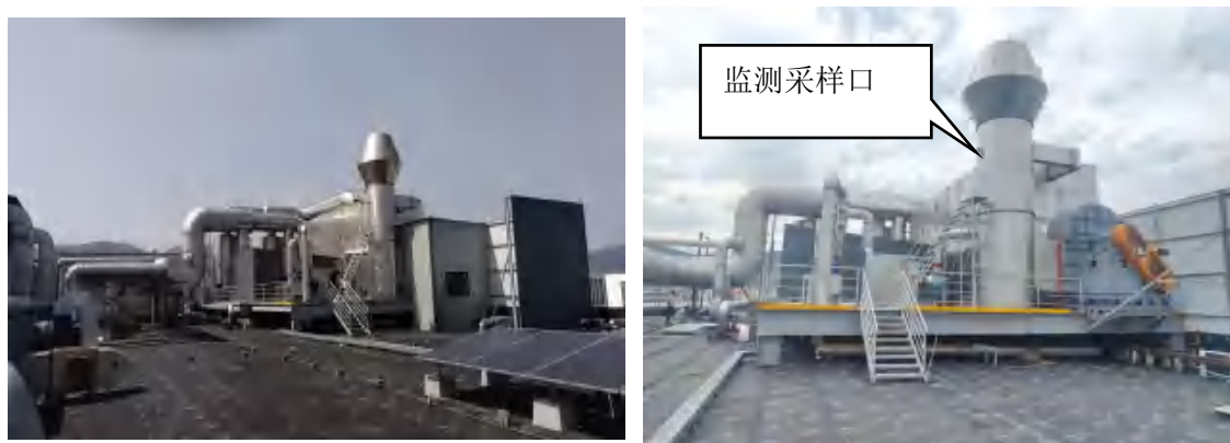
图 4.1-9 油性漆喷漆线废气治理设施
