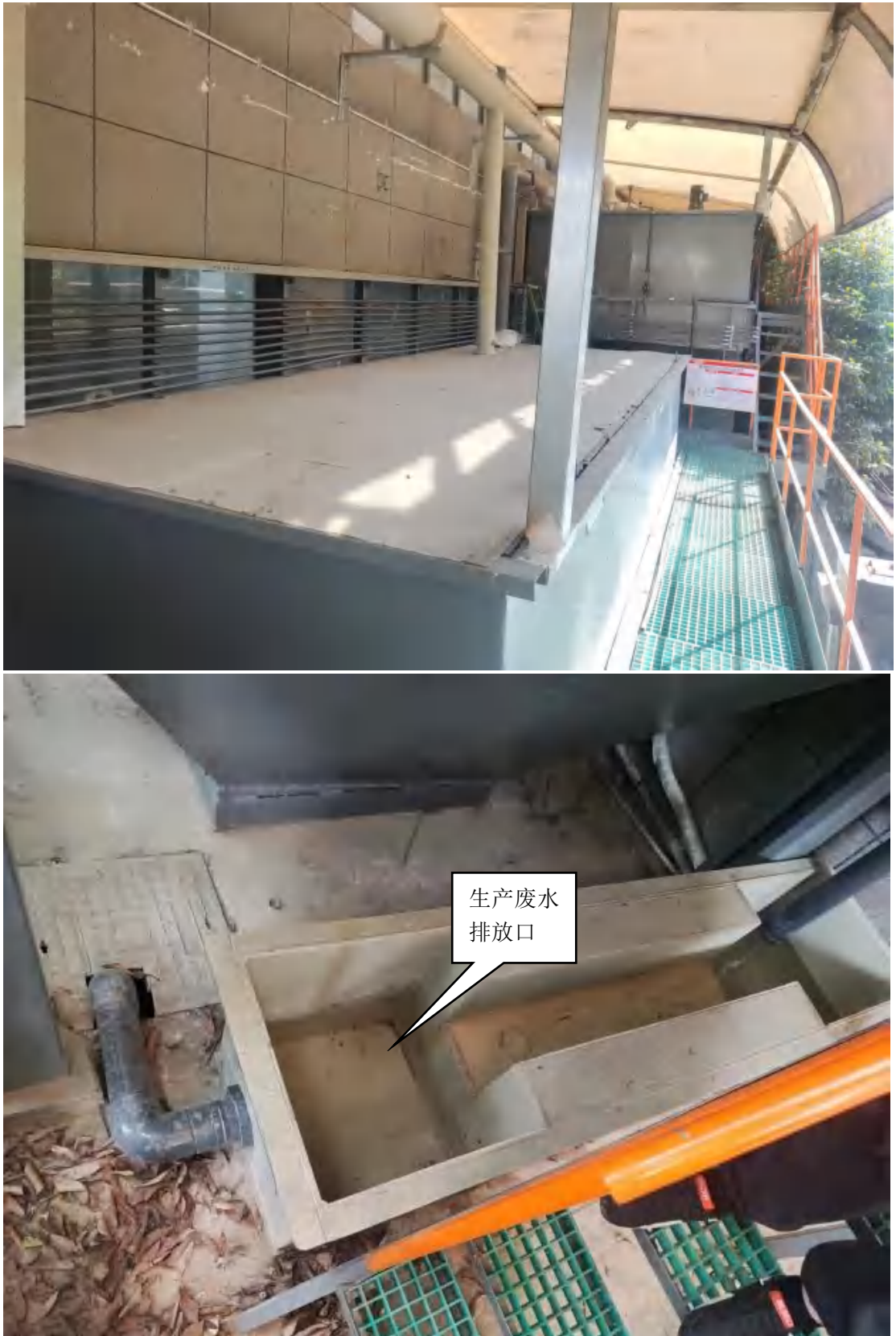
图 4.1-3 厂区污水处理站
